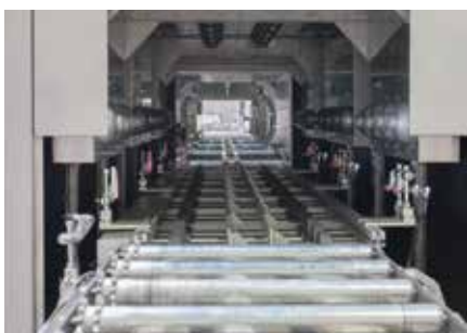
Túnel de enfriamiento
