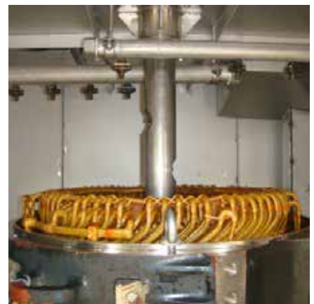
Sistema de lanza para la limpieza interior de los estatores
