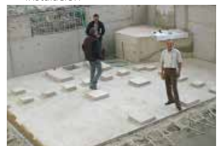
Instalación en fosa
